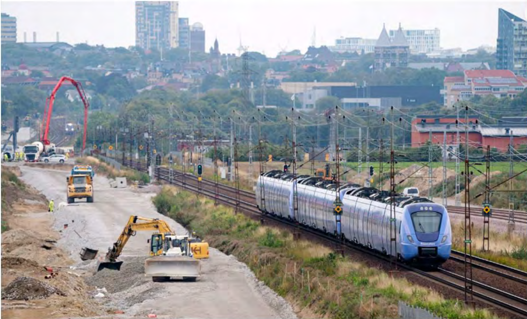
Arbete på sträckan Malmö–Lund år 2020 för bygge av fyra spår i stället för dubbelspår. Foto: Johan Nilsson/TT
